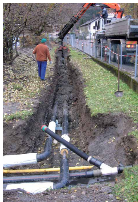
Über eine rund 900 Meter lange Leitungstrasse werden die externen Abnehmer mit Fernwärme versorgt.
