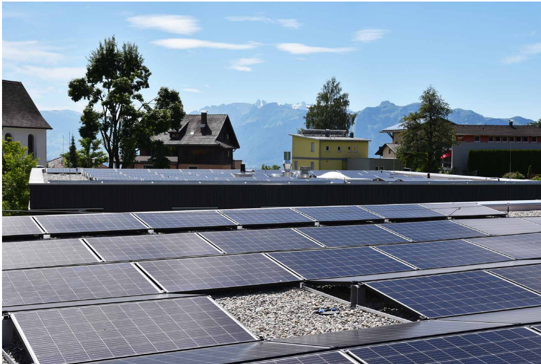
Abbildung 6: PV-Anlagen mit jeweils 30 kW p auf beiden Gebäuden in Dafins Foto: Energieinstitut Vorarlberg
