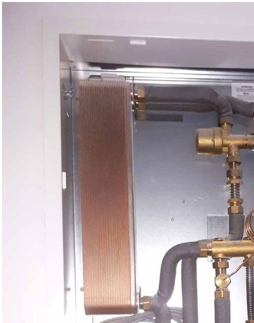
Abbildung 6: Ungedämmte Wohnungsübergabestation in Haus A; Foto: Energieinstitut Vorarlberg
