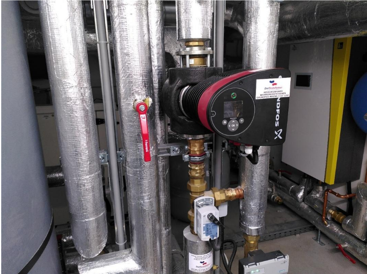
Abbildung 77: Verrohrung Heizungsanlage im Heizungskeller, Haus12a; Foto: Planungsteam E-Plus
