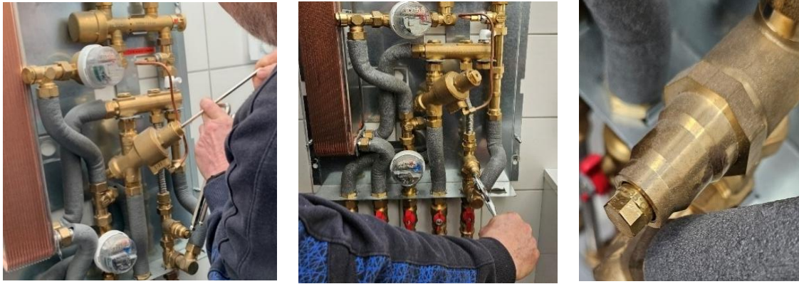
Abbildung 105: Einregulierung des Strangdurchlaufregulierventils, Einregulierung des Bypass-Ventils und Temperatur-Anzeige am Bypass-Ventil; Fotos: Energieinstitut Vorarlberg)
