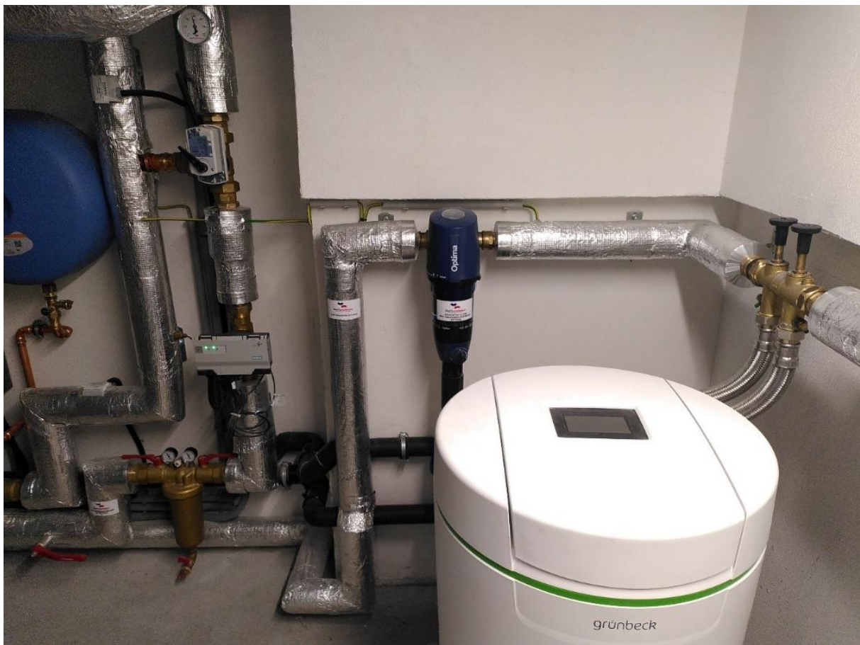
Abbildung 76: Verrohrung im Heizungskeller, Haus 12a; Foto: Planungsteam E-Plus
