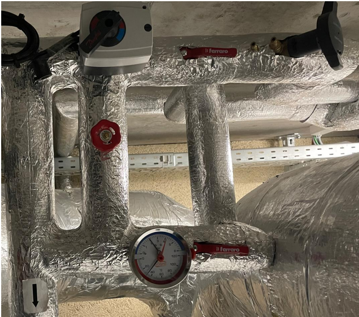
Abbildung 80: lückenlose Rohrdämmung in Vergleichsprojekt; Foto: Planungsteam E-Plus
