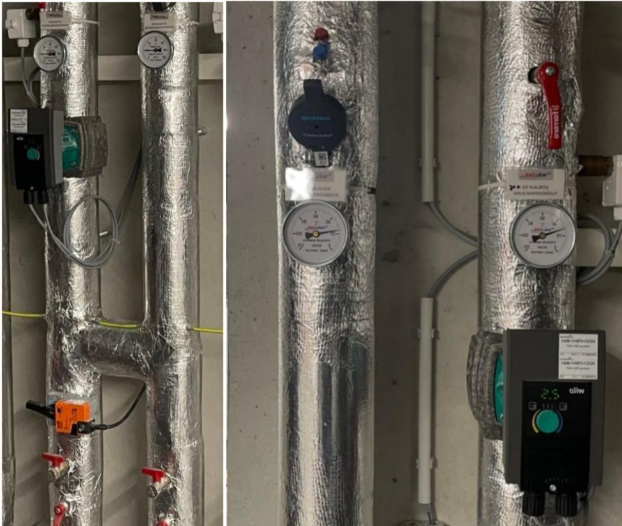
Abbildung 79: lückenlose Leitungsdämmung in Vergleichsprojekt; Fotos: Planungsteam E-Plus
