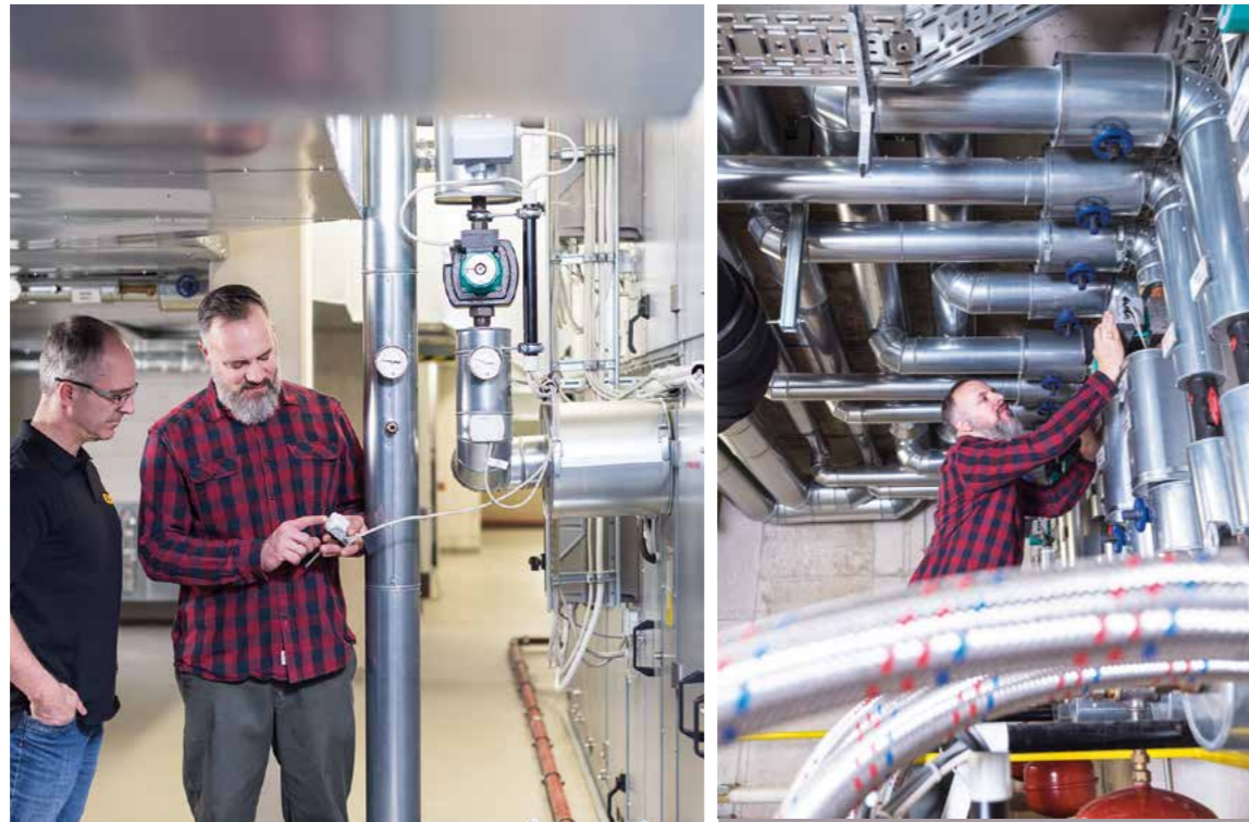
Kontrolle und Optimierung Anlagentechnik
