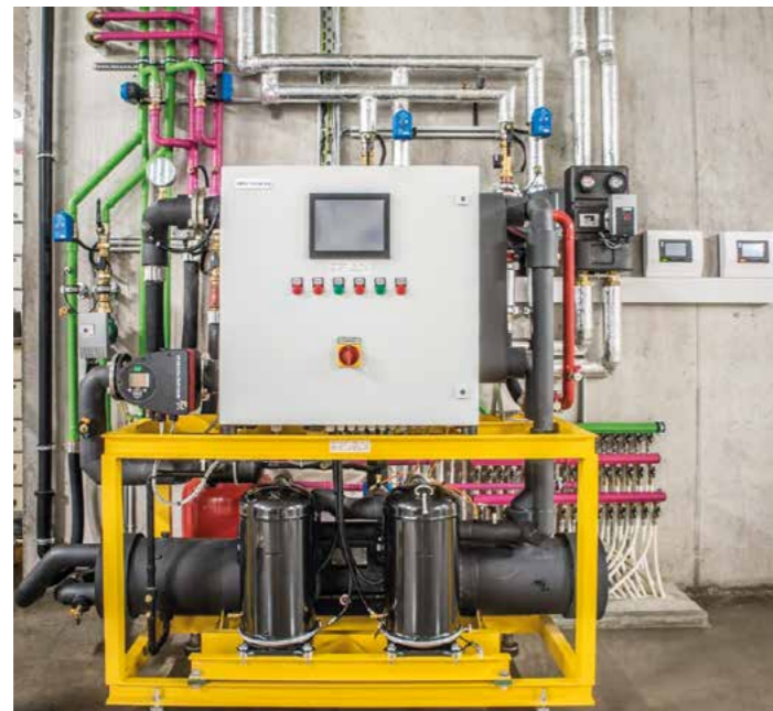
Wärmepumpe gespeist von Solarthermie: vorne 2 x 9 kW Verdichter, hinten NT-Wärmetauscher, rechts oben HT Wärmetauscher, links oben Soleanschluss (Wärmequelle) Naturkosmetik Metzler, Egg
