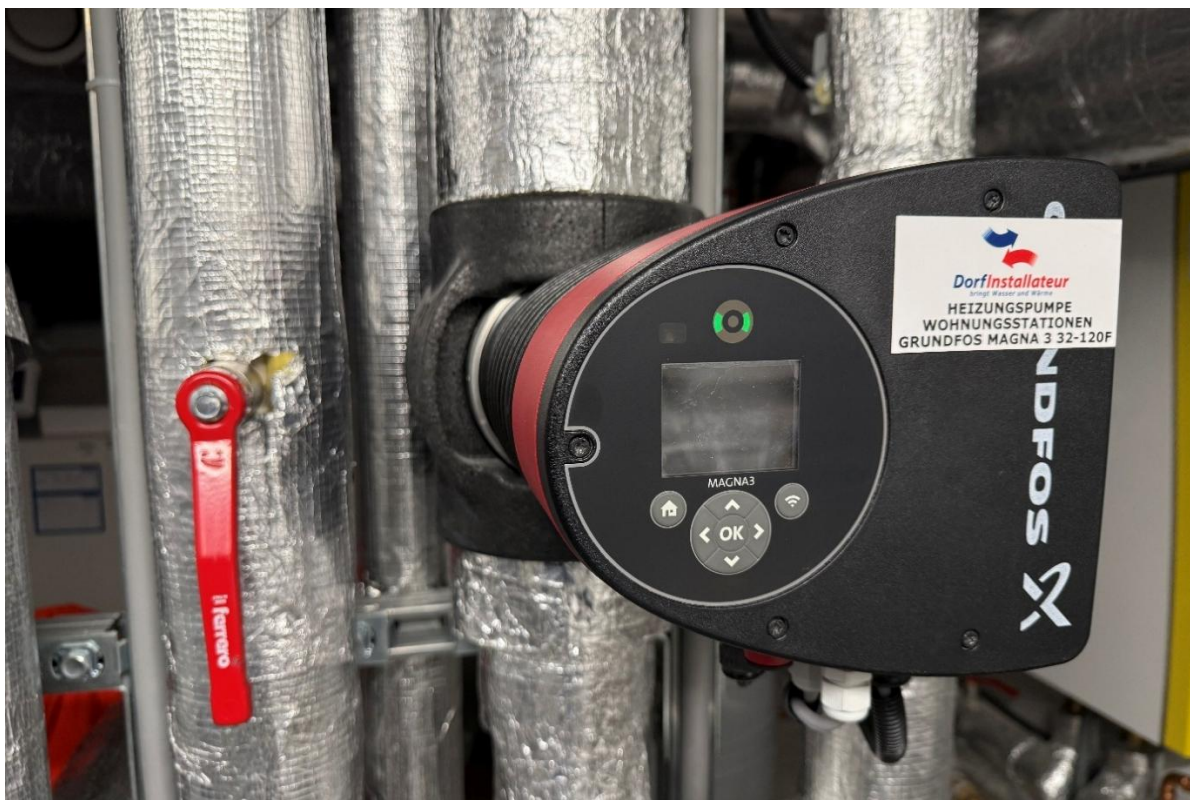
Abbildung 79: Leitungsdämmung großes Gebäude nach Nachbesserungsarbeiten; Fotos: Energieinstitut Vorarlberg
