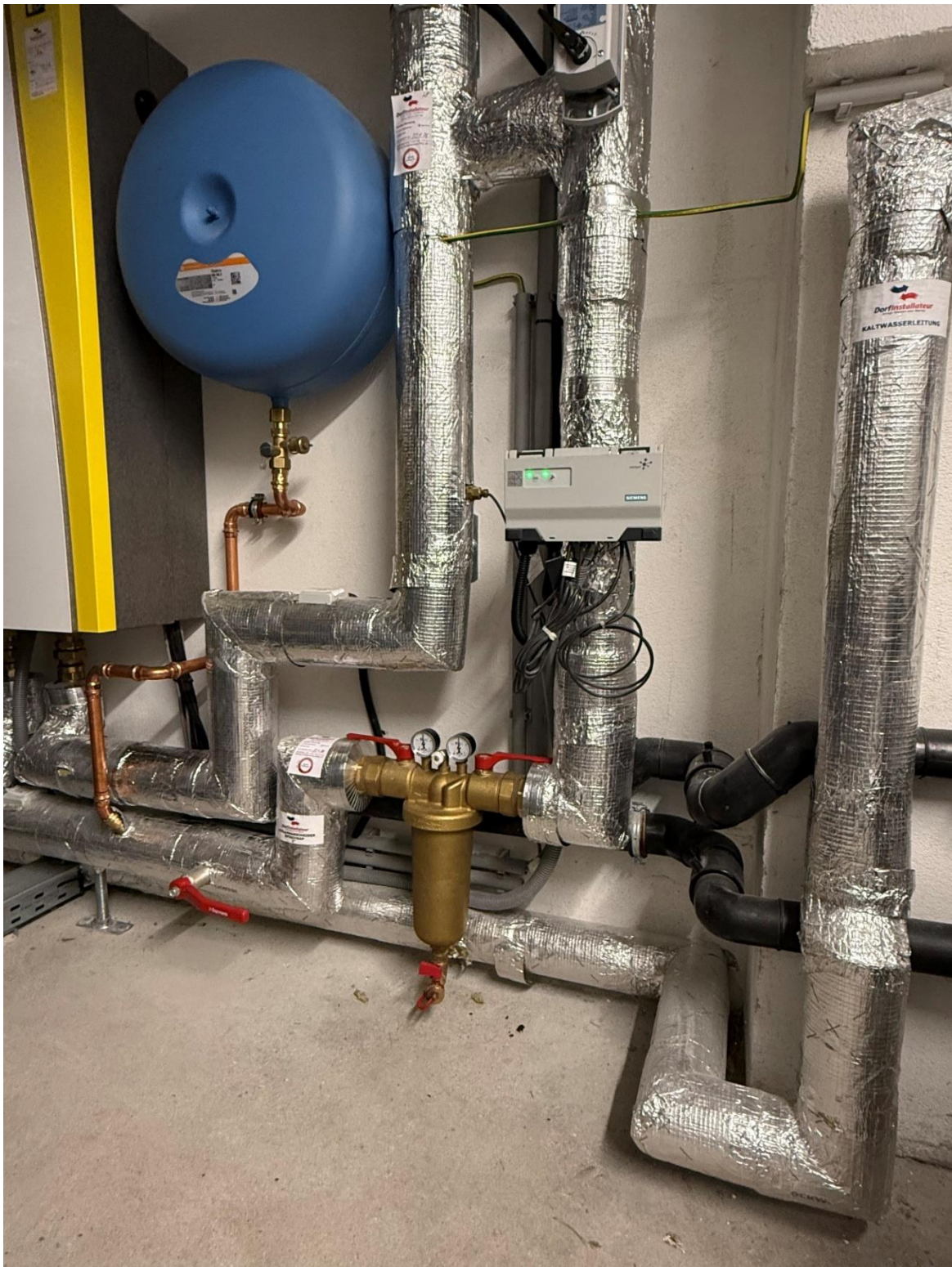
Abbildung 80: Leitungsdämmung großes Gebäude nach Nachbesserungsarbeiten; Fotos: Energieinstitut Vorarlberg
