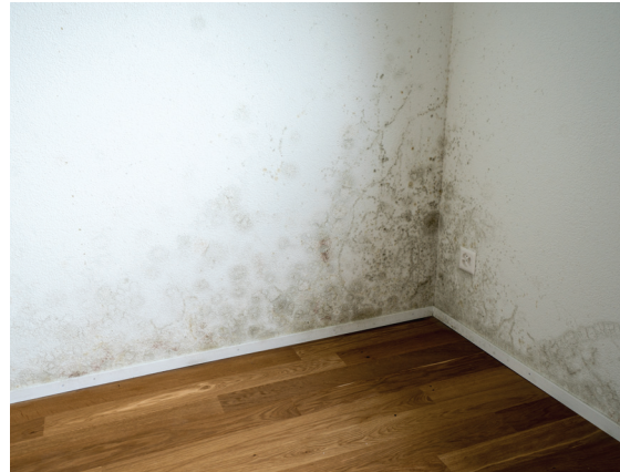
» Besonders Ecken sind schimmelgefährdet.
