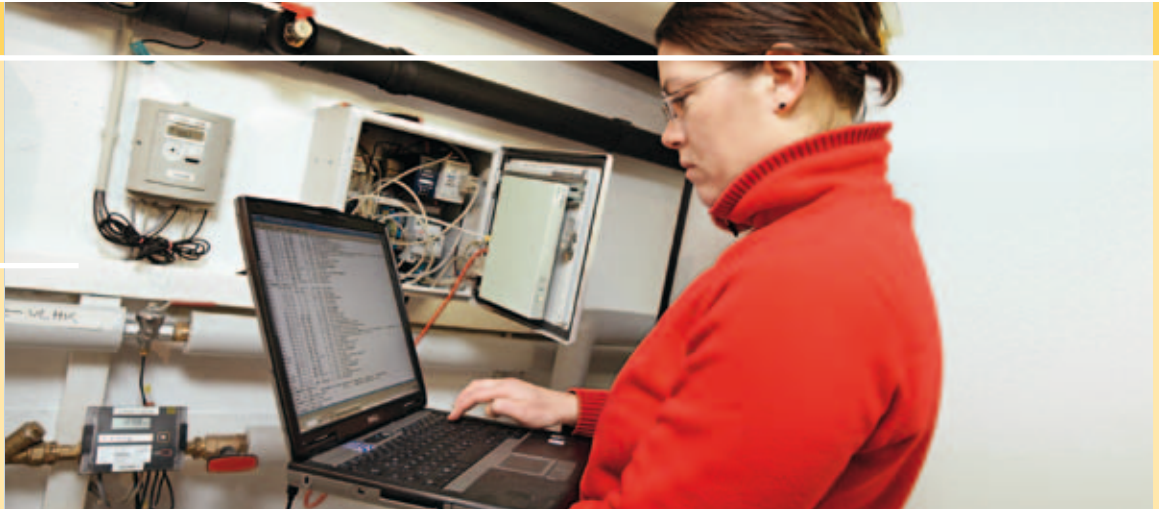
Abb. 20 Vermessung einer Wärmepumpe im Rahmen des Projektes „WP-Effizienz“. Quelle: FhG-ISE
