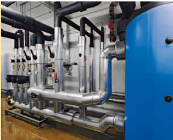
Abb. 9 Speicher in einem Logistikzentrum. Quelle: Bosch Thermotechnik GmbH, Wetzlar
