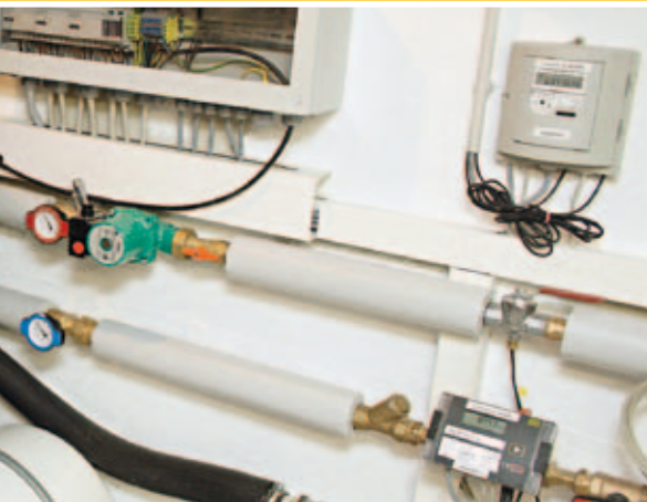
Abb. 26 Installierte Messtechnik Quelle: FhG-ISE
