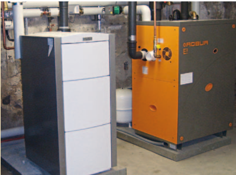
Abb. 16 Die neue Gas-Absorptionswärmepumpe des Schulgebäudes in Plaidt. Quelle: E.ON Energie AG, München
