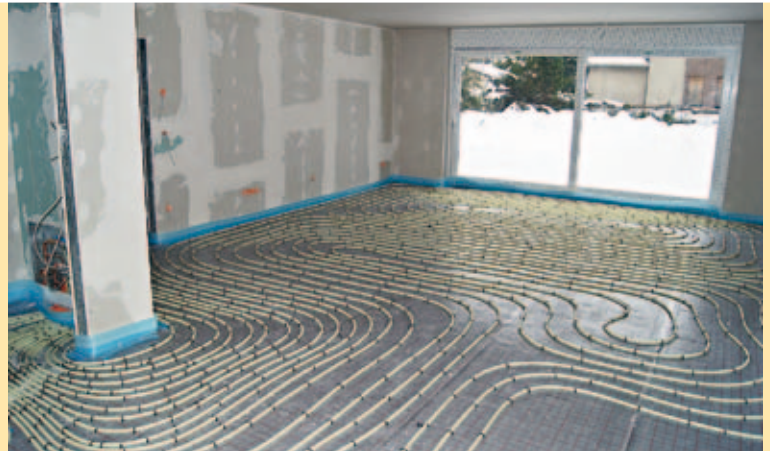
Abb. 13 Fußbodenheizung in einem Neubauprojekt in Duisburg. Quelle: Thomas Lienemeyer, Mülheim a. d. Ruhr
