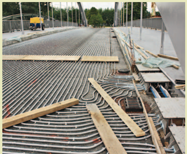
Abb. 8 Fahrbahntemperierung verhindert Blitzeis. Quelle: H.S.W. Ingenieurbüro Rostock
