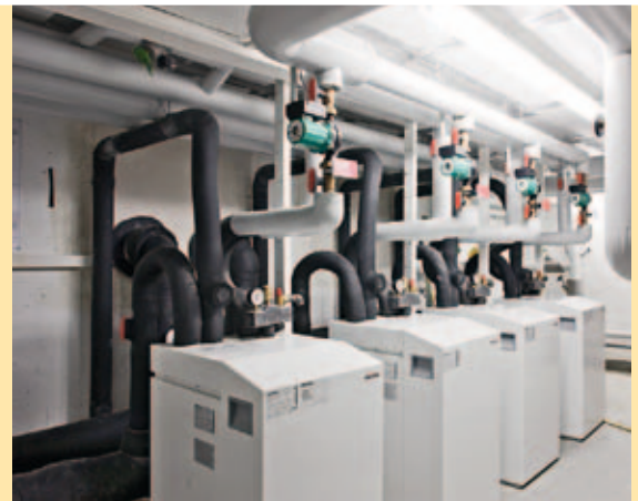
Abb. 10 Wärmepumpen in einem Mehrfamilienhaus in Augsburg. Quelle: Bundesverband Wärmepumpe e. V., Berlin
