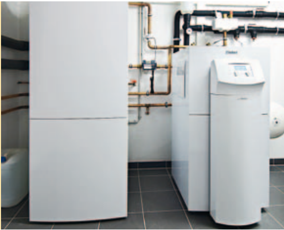
Abb. 12 Wärmepumpenspeicher mit installierter Messtechnik. Quelle: Vaillant Deutschland GmbH & Co. KG, Remscheid
