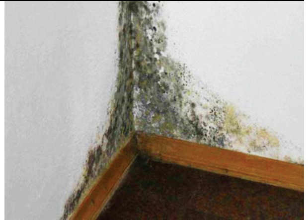
Schimmelpilzbildung in der Raumecke durch fehlende Wärmedämmung der Außenwand
