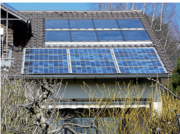
Solaranlagen sind nicht aufeinander abgestimmt.
