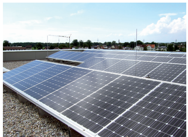
Kollektorfelder bleiben unterhalb der Attika und sind vom Straßen- und Freiraum nicht einsehbar.
